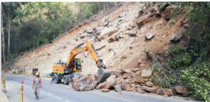
Conformación de terrazas y perforación anclajes para estabilización de talud PR 32+200 paso seguro 6
